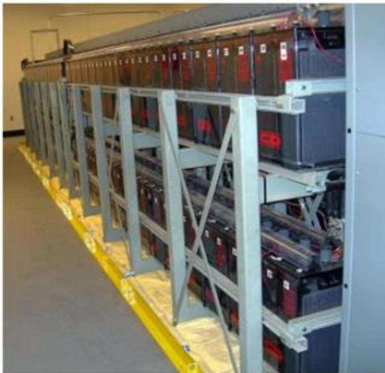
Banco de baterías
