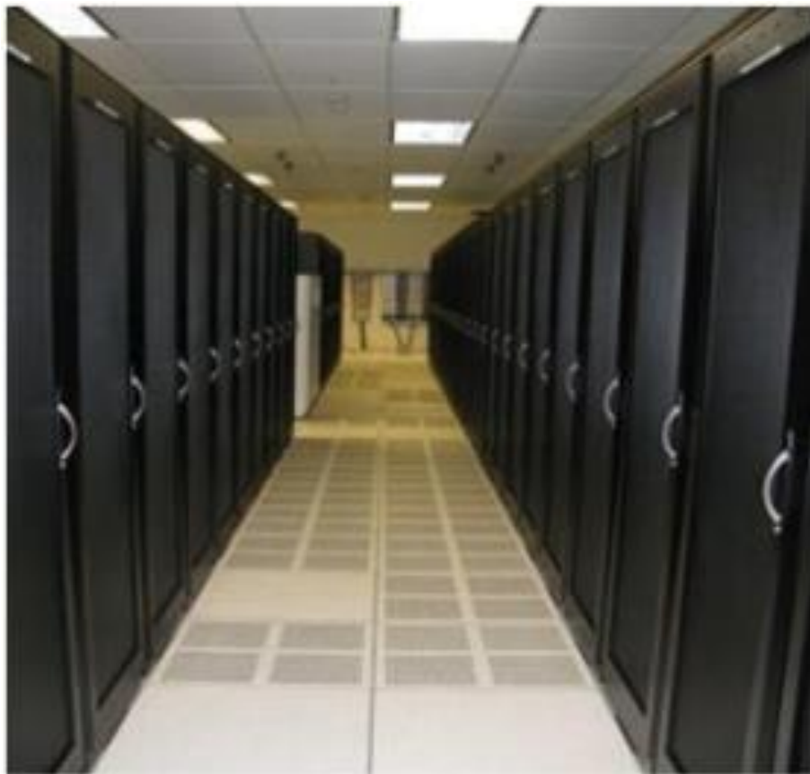
RACK DE SERVIDORES
