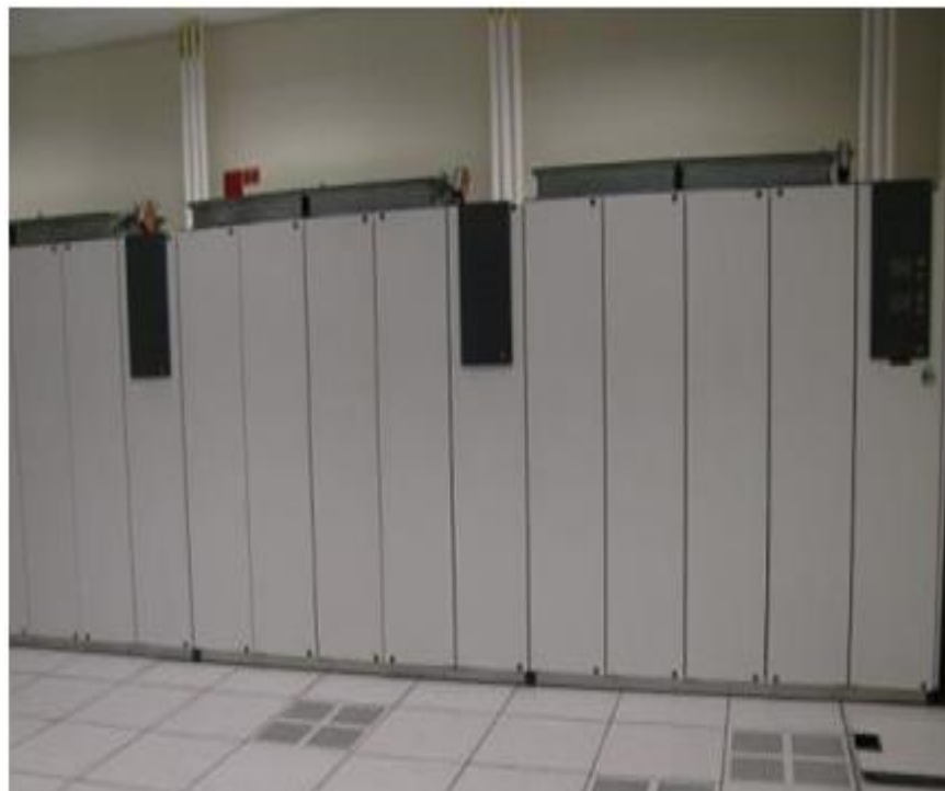
Equipos de A/A
